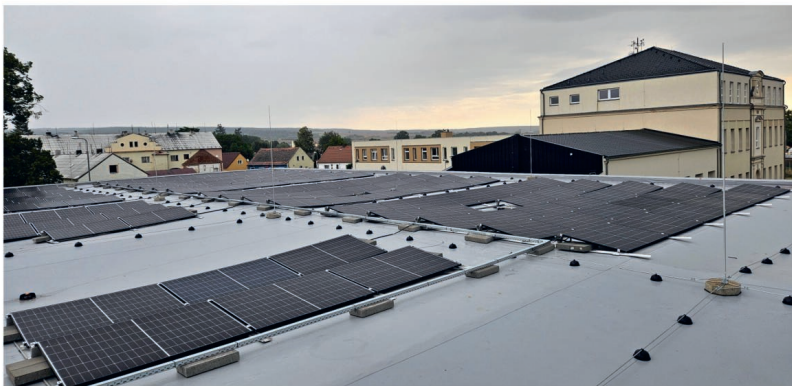
Solární panely umístěné na střeše školní jídelny
