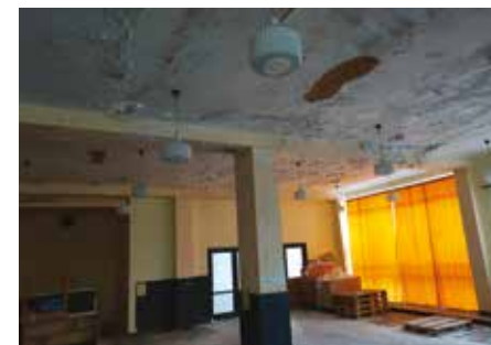
V současnosti je budova kulturního domu v havarijním stavu
